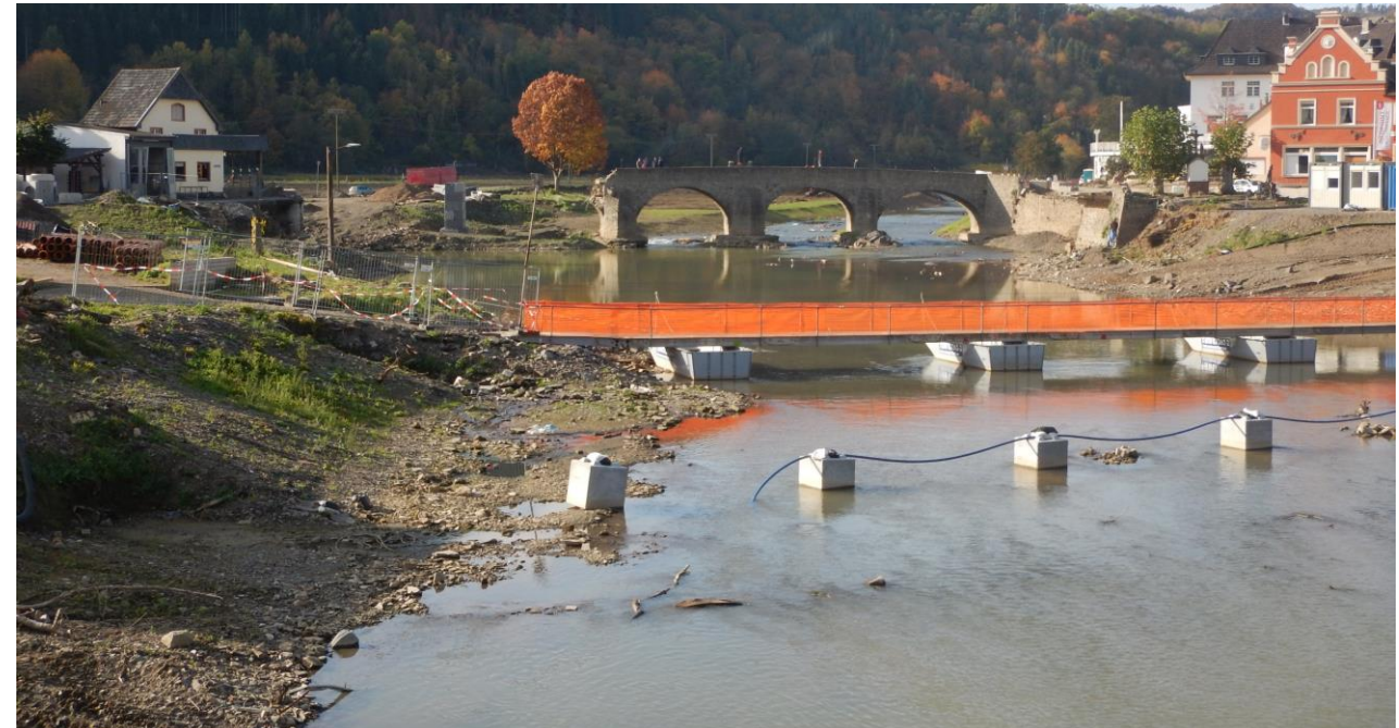
Nepomuk-Brücke mit Gebäuden eingezwängt und ungünstiger Struktur (ist halt was älter) ist zerstört.
