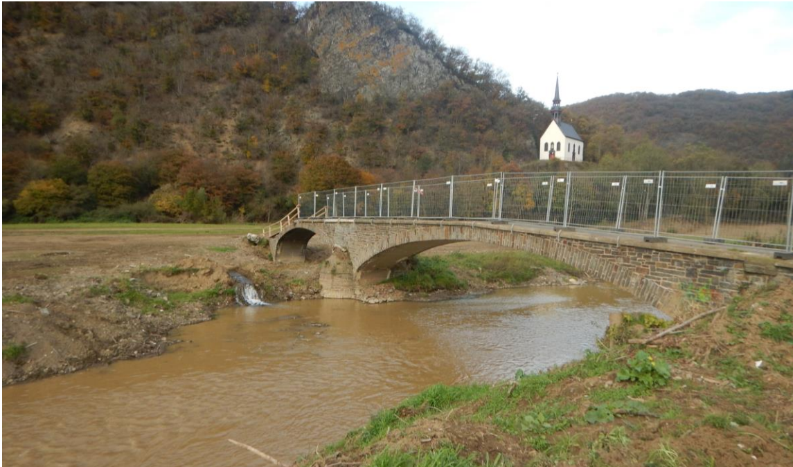
Filigrane Brücke im Oberlauf bei Schuld mit Umströmung hat gehalten.
